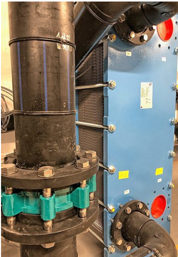
Die neu installierte Seewasser-Wärmepumpe im Beatus.
