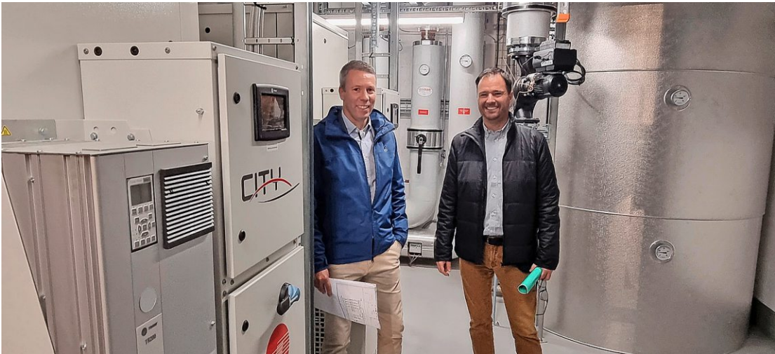
Beat Fuchs von Siemens Schweiz (rechts) und Philippe Baud von der Geschäftsleitung der HLS-Hotels bei der Wärmepumpe im Hotel Beatus in Merligen.
