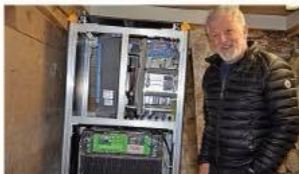
Thomas Näf ist überzeugt, mit seiner Salzspeicherbatterie einen Beitrag ans Sonnenenergie-Dorf zu leisten. Foto: Fritz Leuzinger
