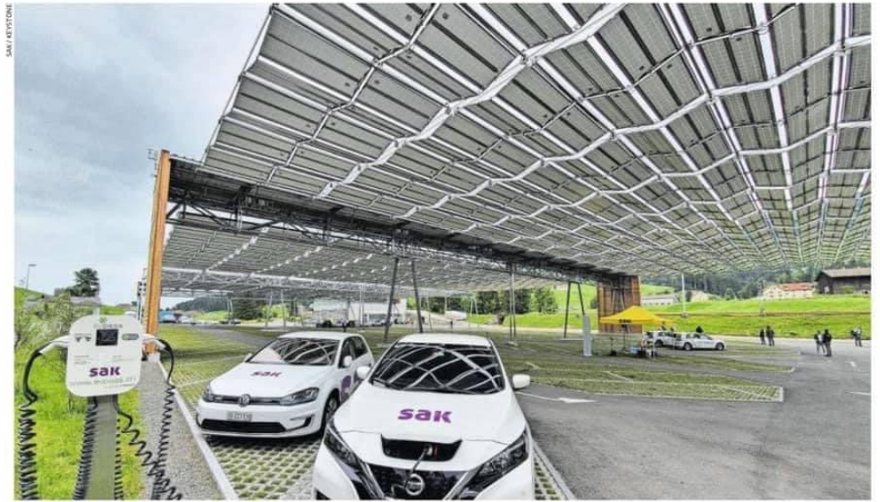
Das solare Parkplatz-Faldach der St. Gallisch-Appenzellischen Kraftwerke (SAK) in Jakobstad AI. (22. Juni 2020)
