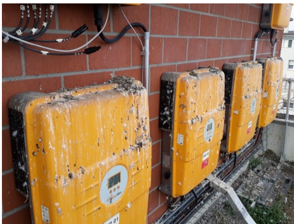
Abbildung 4: Verschmutzte Wechselrichter, Jendra Power AG
