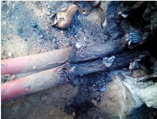
Abbildung 7: Kabelbrand, Jendra Power AG
