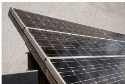
Die Anlage besteht aus 72 Modulen des Typs M55 Siemens Monokristall.
