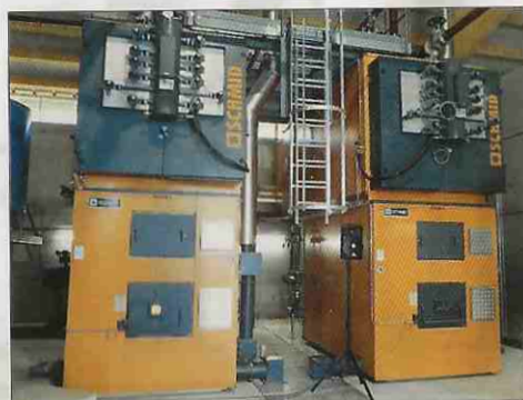
Die Energieproduktion ist mit zwei riesigen Holzkesseln gesichert.
