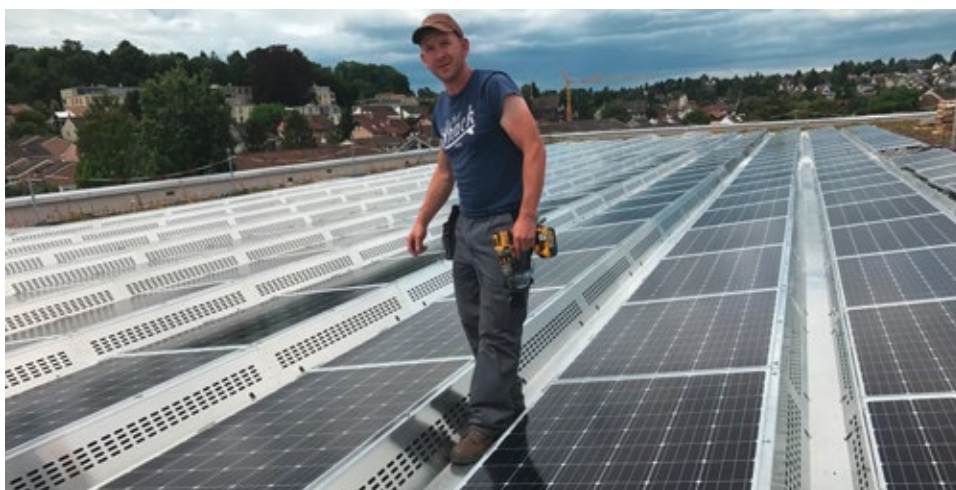
Auf dem Spital Balgrist in Zürich liefert eine ADEV-Solarstromanlage Solarstrom, der direkt im Gebäude verbraucht wird.
